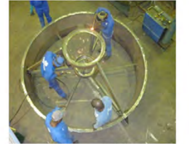
FIN FAN COOLING
